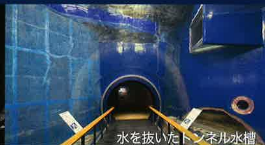
水槽の大規模な破損
